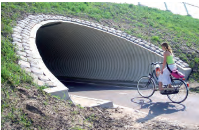
Multi-plate, gegolfd stalen duikers en tunnels
